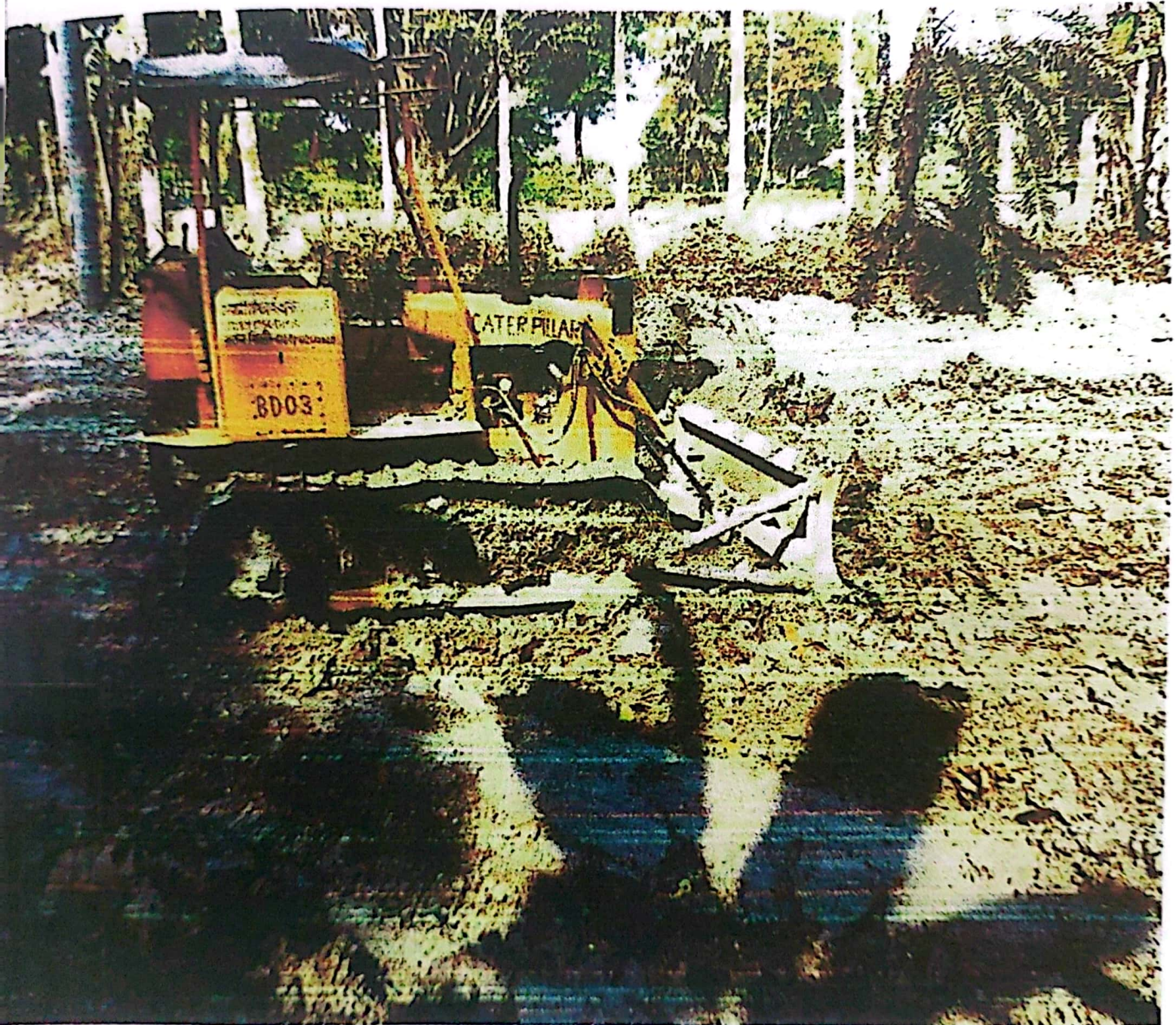
Barisal -Faridpur 230 KV Double Circuit Transmission Lien
